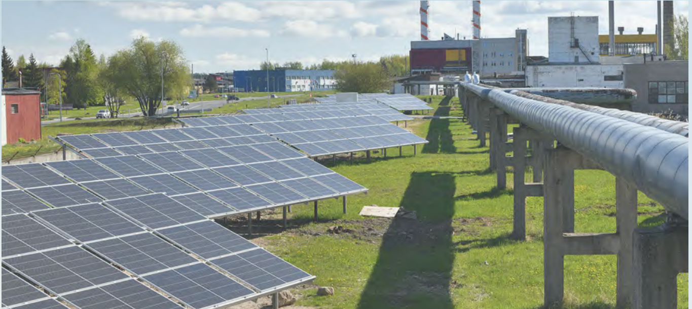
Saulės fotovoltinė elektrinė (249 kW galios) Panevėžys
