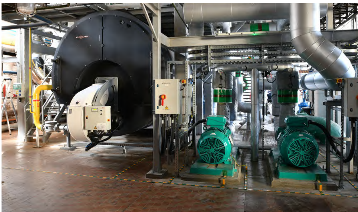
13,1 MW galios katilas, Panevėžio elektrinės katilinė
