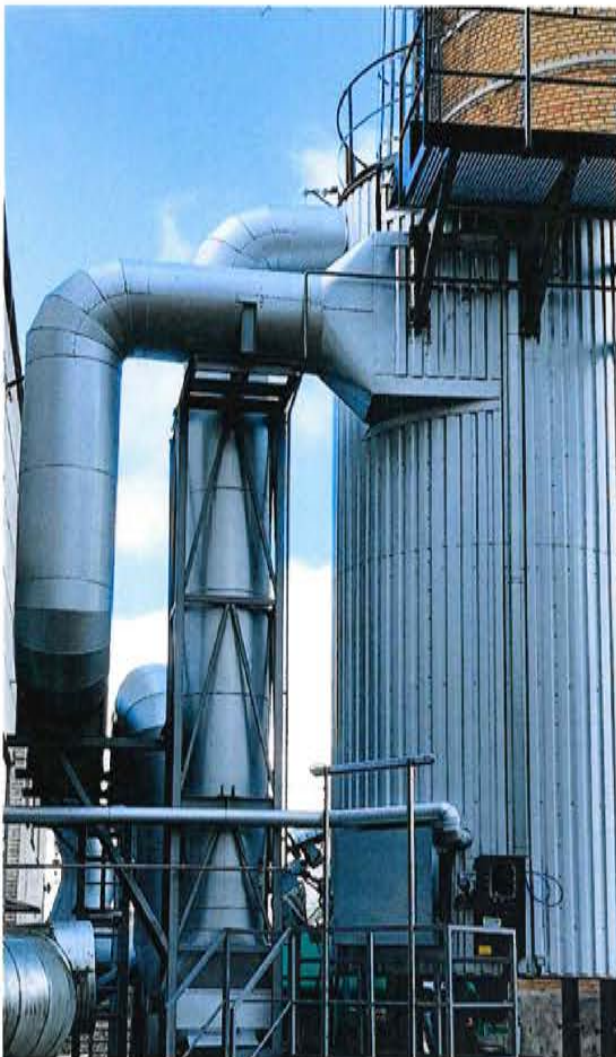
(Kėdainių ŠTR Akademijos katilinės dūnų valymo filtrai)
