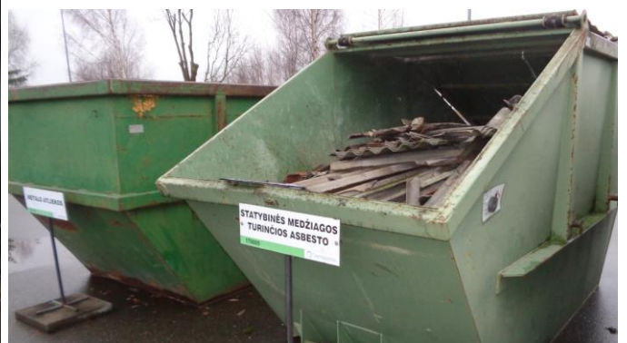
11 pav. Statybinių medžiagų, turinčių asbesto atliekos
