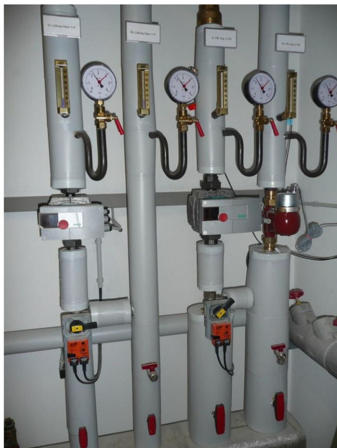
112 pav.: Izoliuoti šildymo vamzdžiai © ZEBAU GmbH
