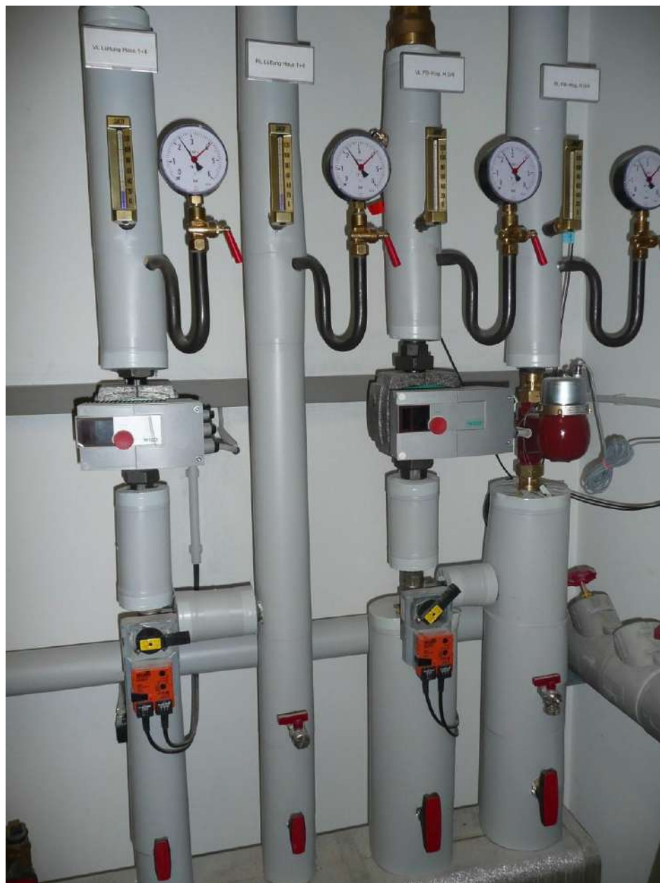
122 pav.: Izoliuoti šildymo vamzdžiai © ZEBAU GmbH
