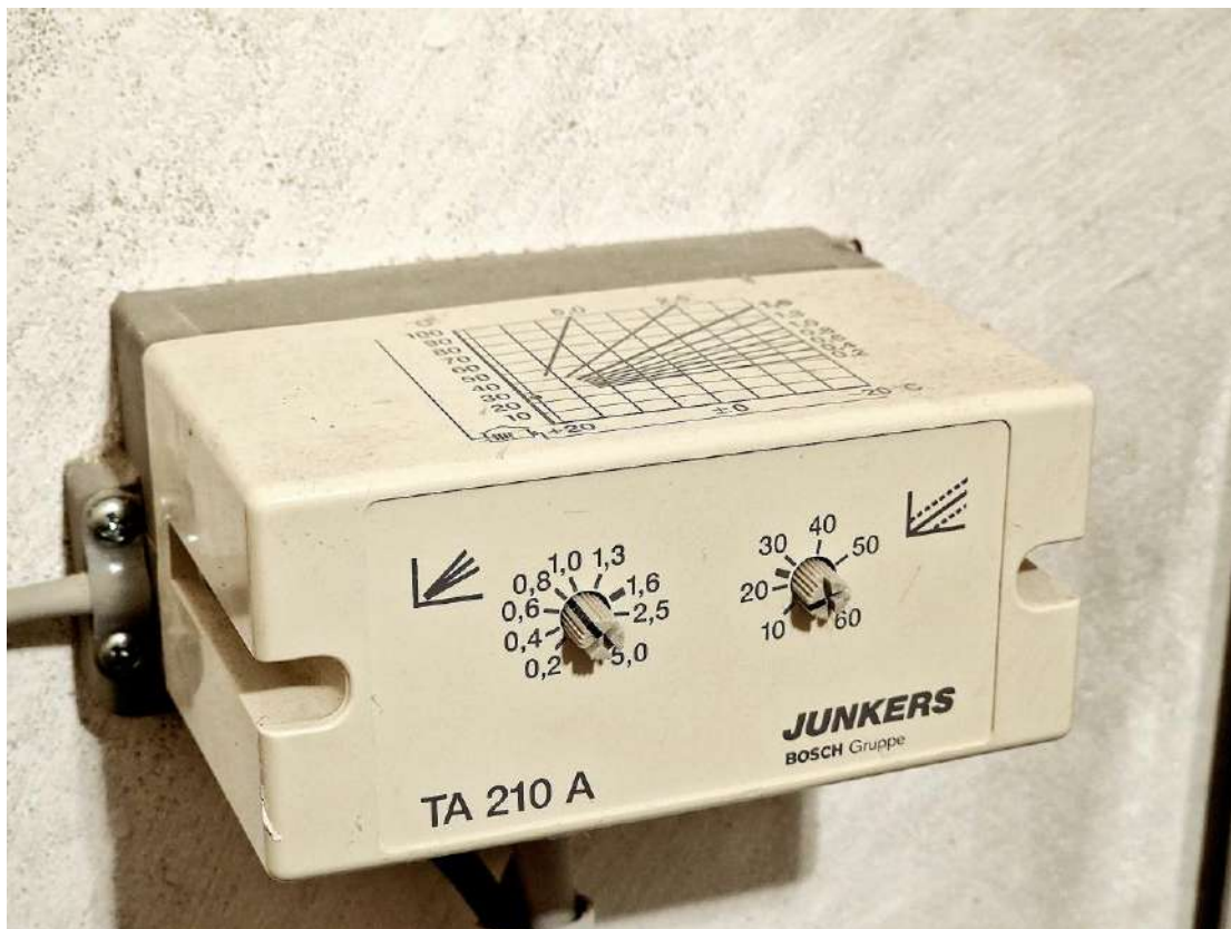
14 pav.: Valdymas pagal lauko temperatūrą © ZEBAU GmbH
